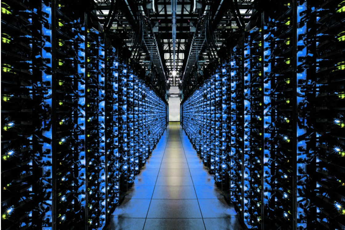
Serveurs de Google, Etats-Unis, 2012. (Photo : Google/ZUMA/REA)
